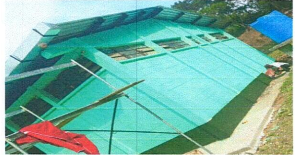
Foto 2: techo un costado de salon
